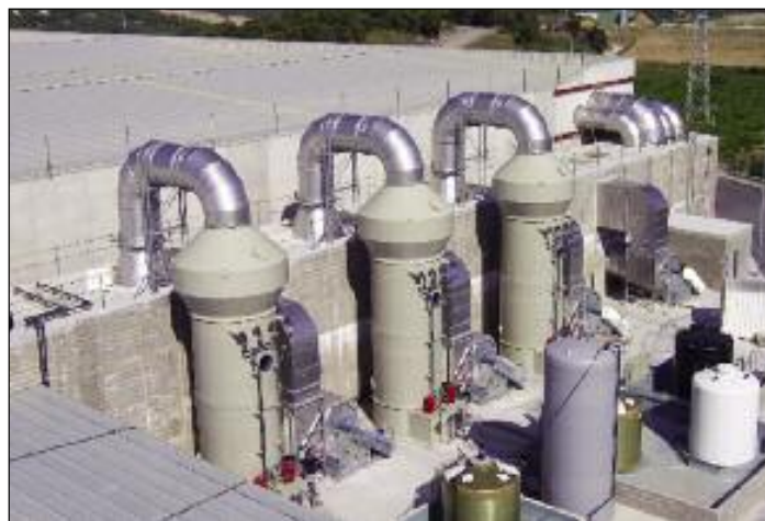
Sezione deodorizzazione a servizio impianto trattamento rifiuti: biofiltro Monafil coperto e sezione trattamento chimico con portata 300.000 mc/h
